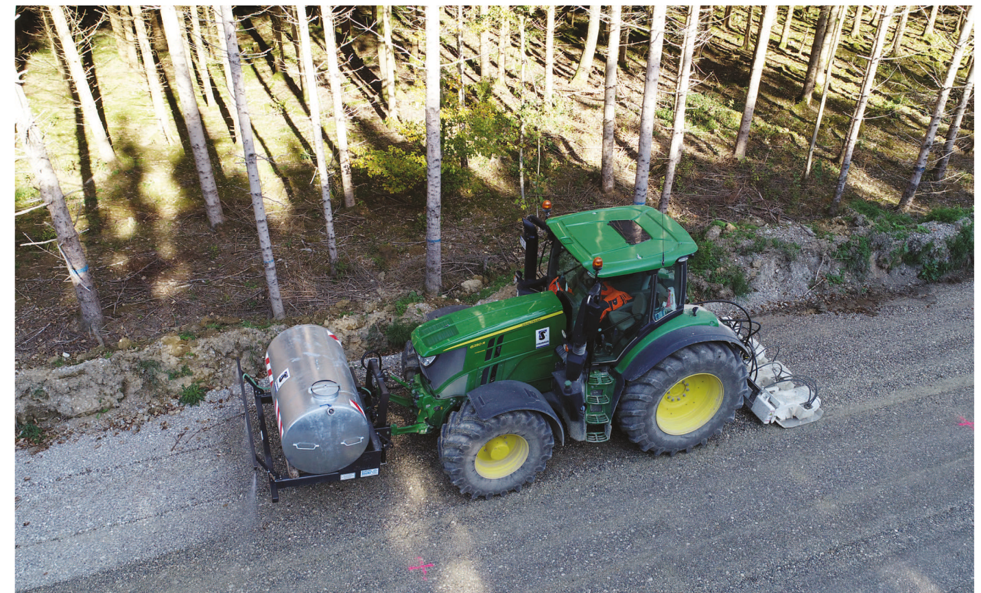
Aus der Luft ist gut zu sehen, wie exakt Berieselungsanlage und Plattenverdichter zusammenarbeiten. Durch die präzise Dosierung wird kein kostbares Frischwasser verschwendet.
